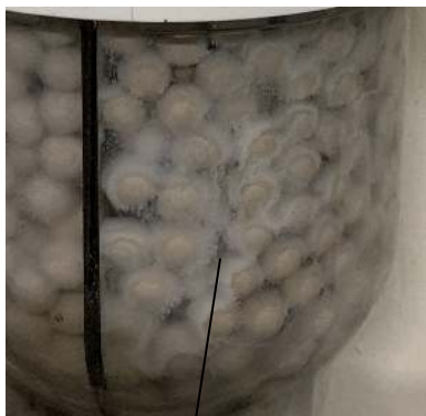
Figure 3 - Précipité de sel déposé sur le média neutralisant des échangeurs de chaleur en aluminium
