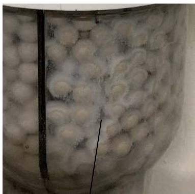
Figure 4 - Précipité de sel déposé sur le média neutralisant des échangeurs de chaleur en aluminium
